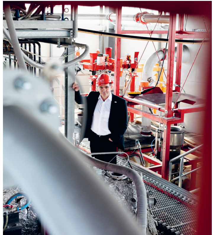
Professor Bernd Eppler an der fachgebietseigenen Megawatt-Technikumsanlage.
