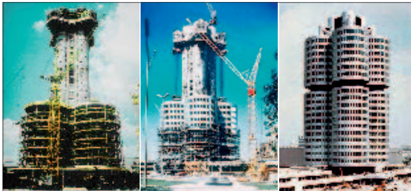
Bild 6: Kern; Hubzustand mit teil- weiser Fassade; fertiger Zustand Core; under construction with partial fixed façade; Final state
