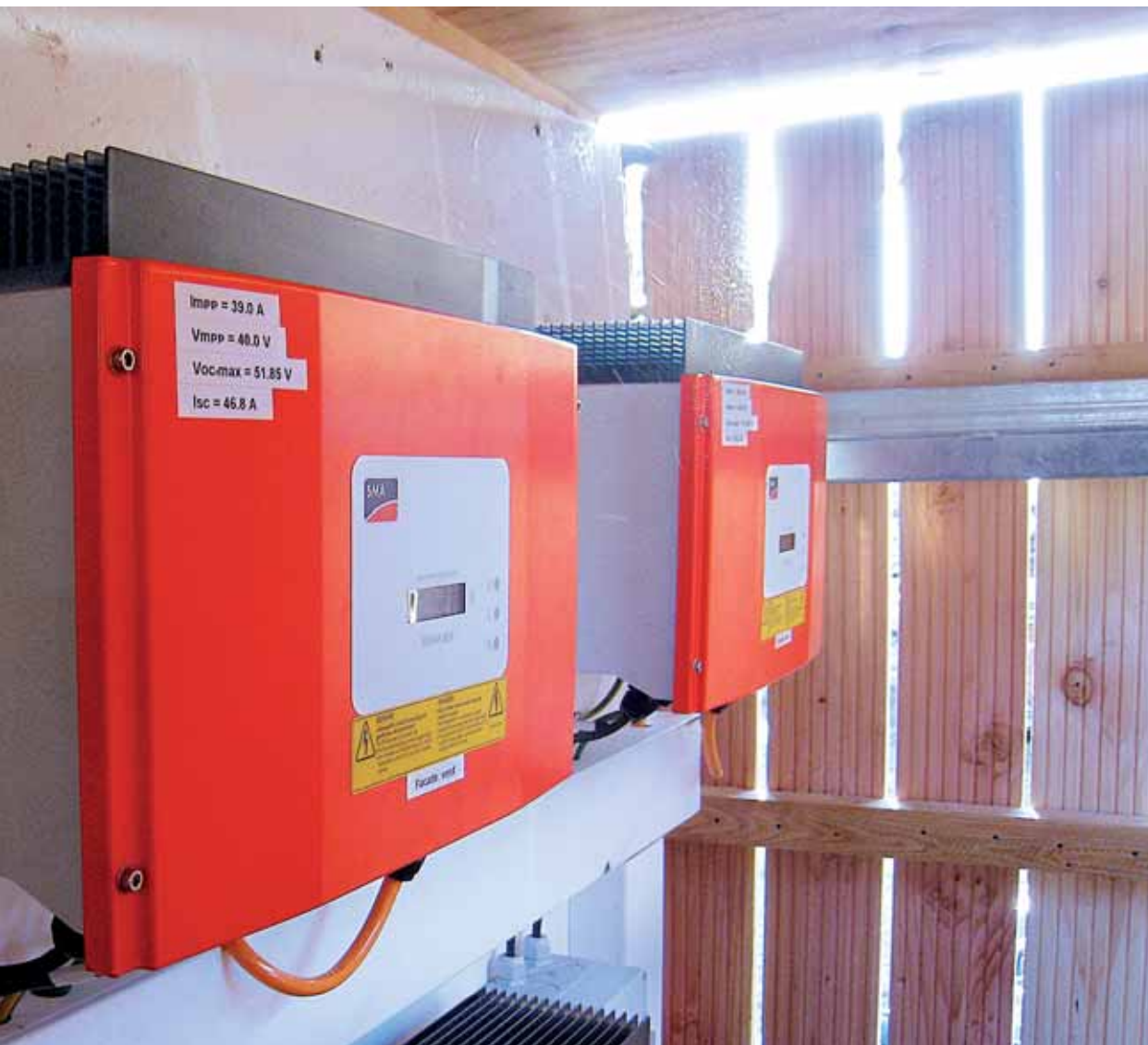
Abbildung 1 19kWp Photovoltaik Leistung.
