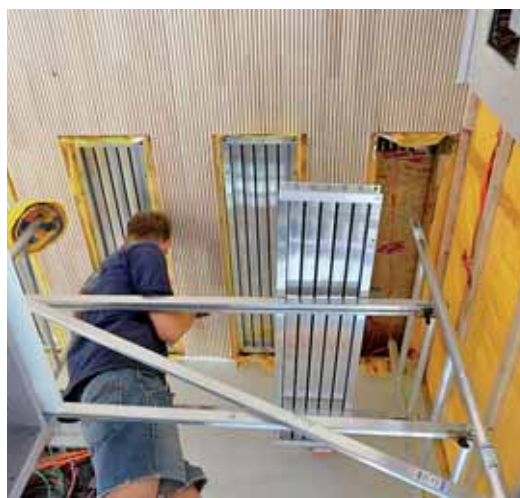
Abbildung 6 Einbausituation der Klappen der Kühldecke zum Innenraum.
