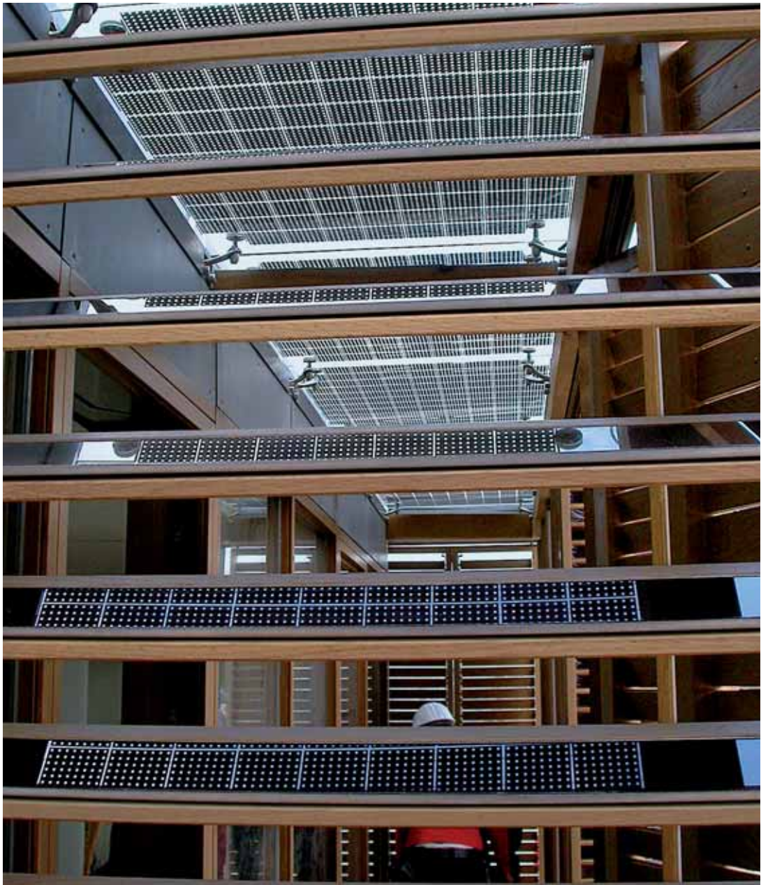
Abbildung 5 In Holzlamellen integrierte Dünnschicht-Photovoltaikmodule und Blick durch die gläsernen Photovoltaikmodule im Dachbereich.
